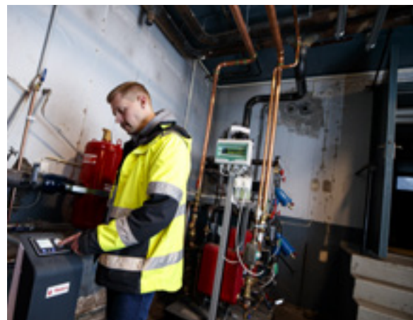
Johan Enström vid den nya undercentralen på Boken 12.
